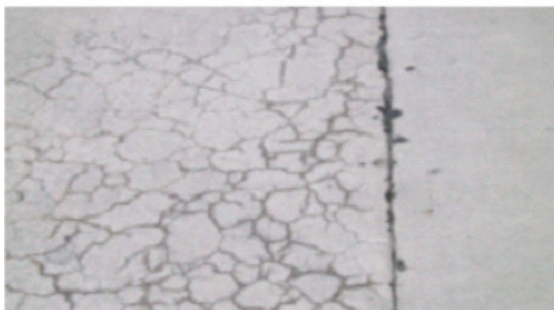
Rys. 1. Pęknięcia w nawierzchni betonowej wywołane reakcją aktywnej krzemionki z wodorotlenkami sodu i potasu (Touma et al 2001)
