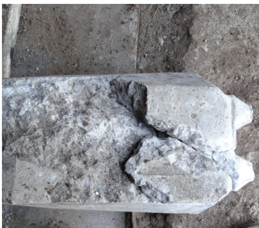
Rys. 9. Przykładowe uszkodzenia podkładów kolejowych: a) rozszczepienie, b) zniszczenie zainicjowane przez rozrywanie czoła elementu
