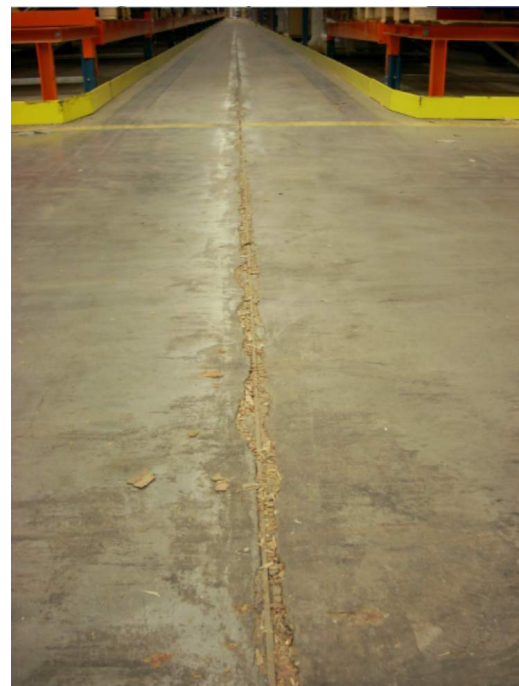
Rys. 2. Uszkodzenia posadzki w magazynie P1 obejmujące znaczne wykruszenia w pasach wzdłuż wbudowanych prowadnic listew
